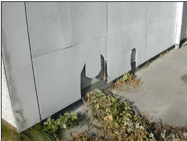
Exempel på fogmassa som är dold bakom fasadplattor.
