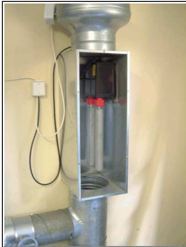
Lukstörningar förekommer? Då kanske detta kan vara lösningen. En joniseringsanläggning (luckan borttagen för att rören skall synas) i en pumpstation. Foto Martin Holm
