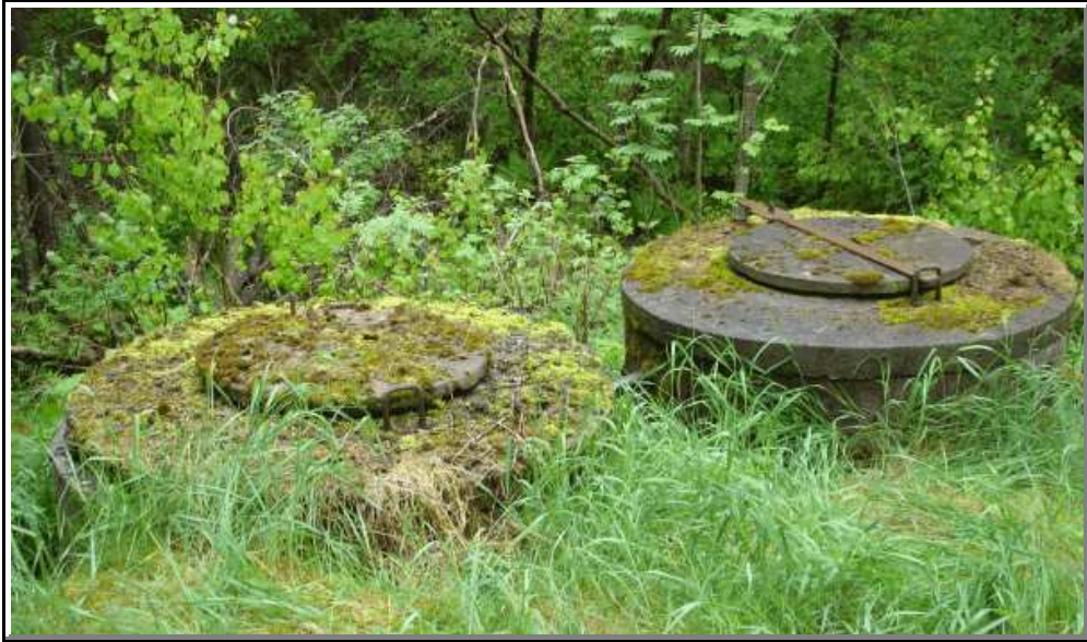
Slamavskiljare vid markbäddsanläggning. När lyftes dessa lock senast? Här kan inspektören lätt konstatera att egenkontrollen brister. Foto Marika Palmér-Rivera
