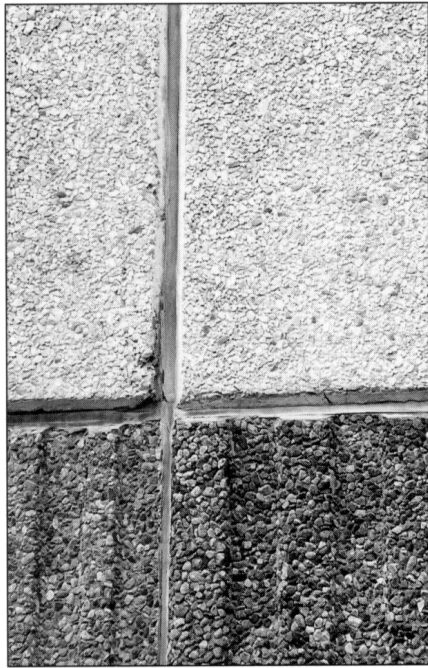
Fogar med PCB-innehållande polysulfidfogmassa mellan betongelement. Fogen är typisk för en betongelementbyggnad.
